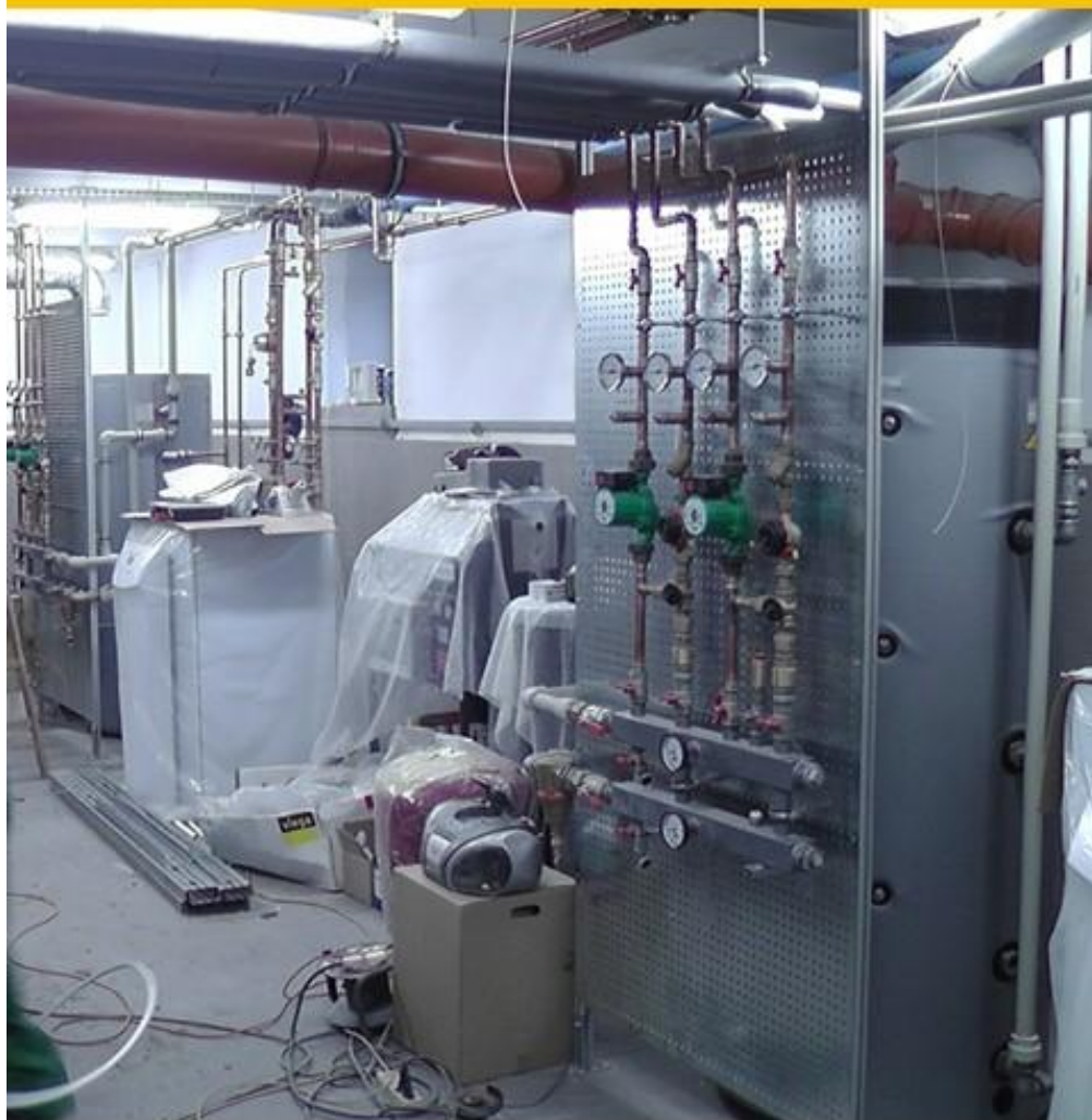
KOTŁOWNIA POMP CIEPŁA 2 POMPY VAILLANT 2 POMPY VIESSMANN 56KW
