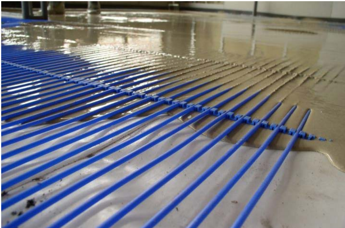
► Ogrzewanie matami kapilarnymi w warstwie wylewki
