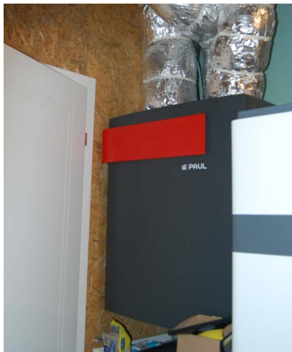
► Rekuperator Paul Novus 450 znajdujący się w pomieszczeniu technicznym
